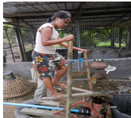
Die defekte Wasserpumpe wurde ersetzt.
